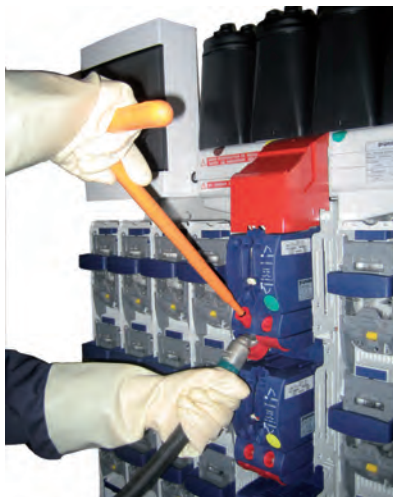
Maniobra de conexión a un grupo electrógeno. Connection of a generator.
