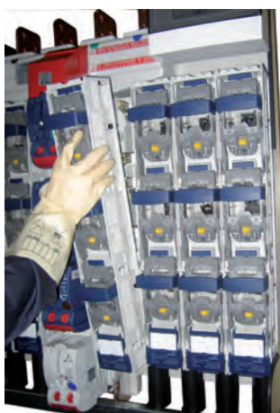
Ampliación de salidas mediante la colocación de una base TRIVER+ en un hueco.
