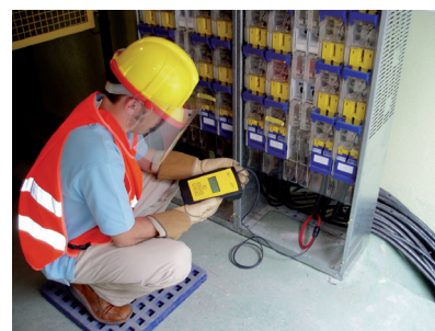
Identificación de cable con el receptor Ariadna IC1G-RX .
