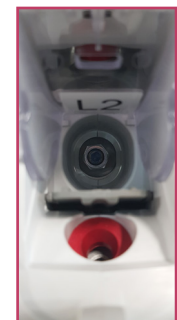
Acceso al embarrado Access to the busbar
