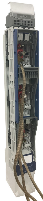
Conexión puesta a tierra Earthing device
