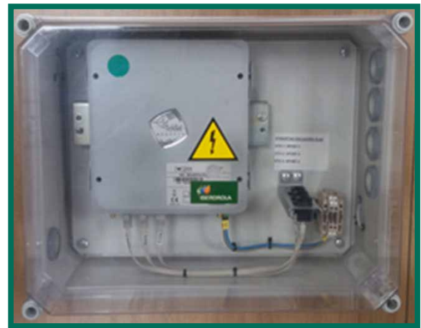
ARMARIO CON EQUIPO INSTALADO
