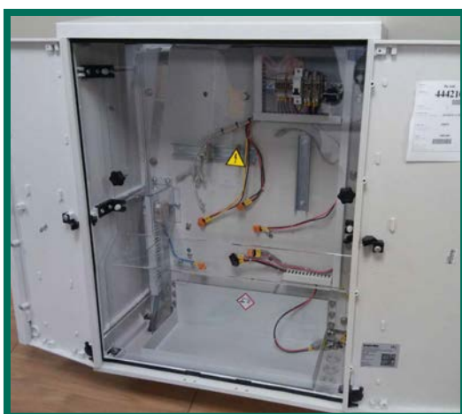
ARMARIO SIN EQUIPO
