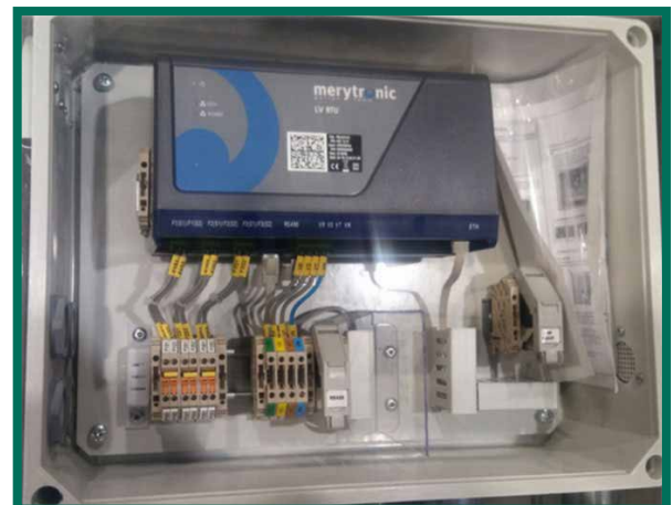
ARMARIO CON EQUIPO INSTALADO
