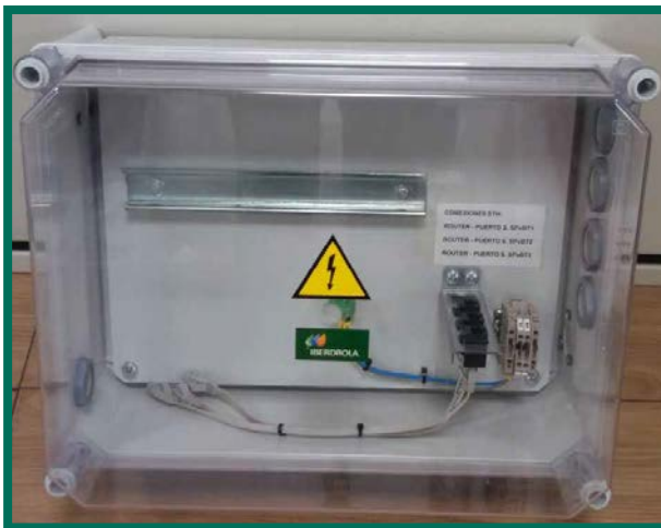
ARMARIO SIN EQUIPO
