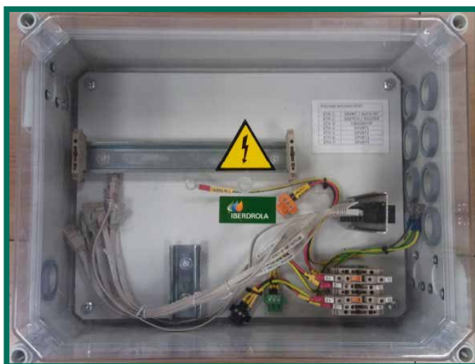
ARMARIO SIN EQUIPO
