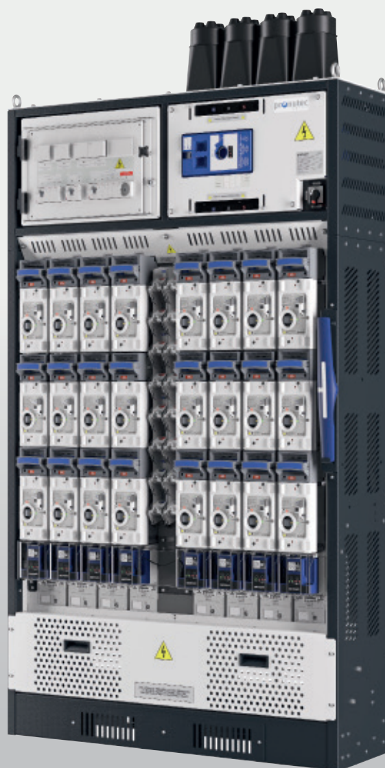
Zillion NEULAN Cuadro automatizado de baja tensión Protected by Pronutec
